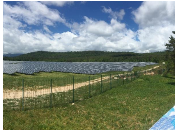
Figure 20 : Parc photovoltaïque installé sur la commune
