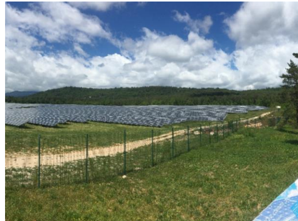
Figure 21 : Parc photovoltaïque installé sur la commune
