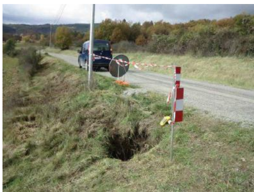
Effondrement localisé, novembre 2015 RD16 commune de Sigonce © GEODERIS
